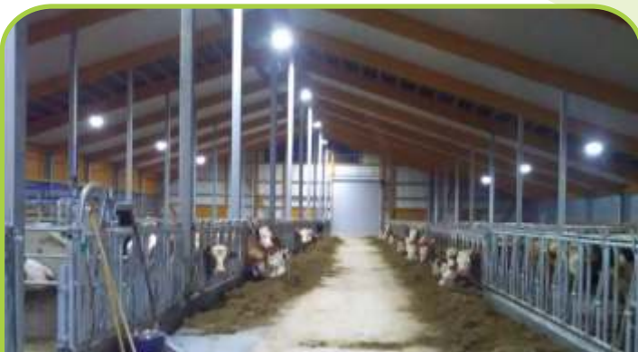
Kundensituation Neubau 80 & 140W Rundleuchten mit Lichtmanagement
